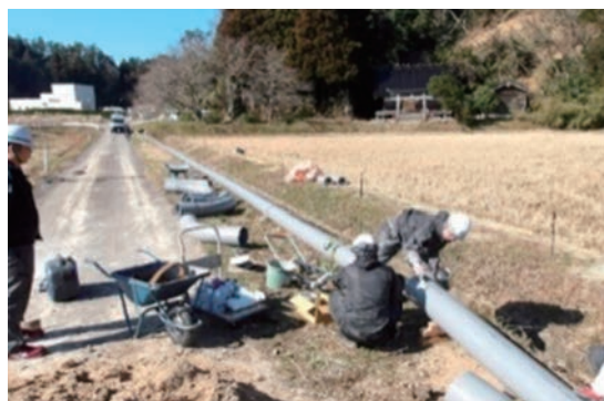
▲写真3 下水を集約し下水処理場にする圧送管の被災現場（珠洲市）
