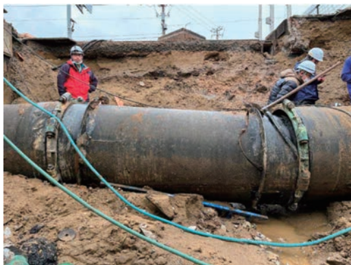
▲写真2 送水管の被害（七尾市）
