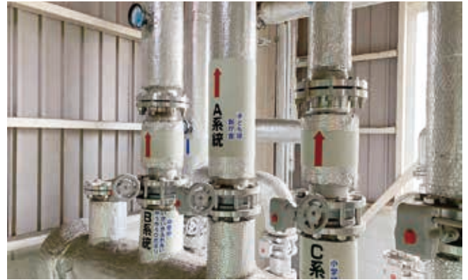
▲ボイラーで生まれた熱を公共施設へ運ぶ熱供給管
