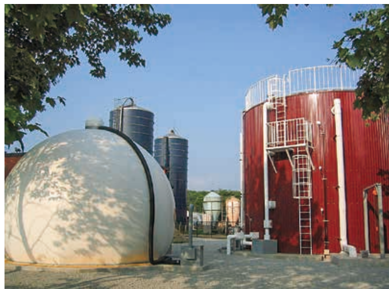
▲畜ふんバイオガスプラント。施設規模は13トン/日（乳牛200頭）で、家畜排せつ物等を原料に、熱や電気、有機肥料を回収・有効利用することができる
