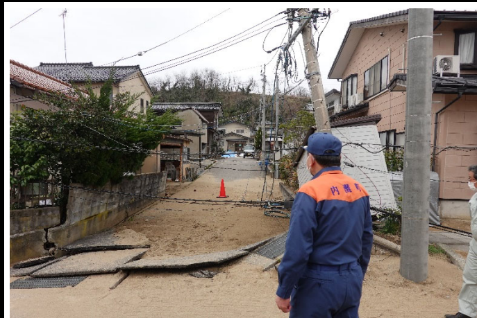
液状化被害を受けた西荒屋地区 1
