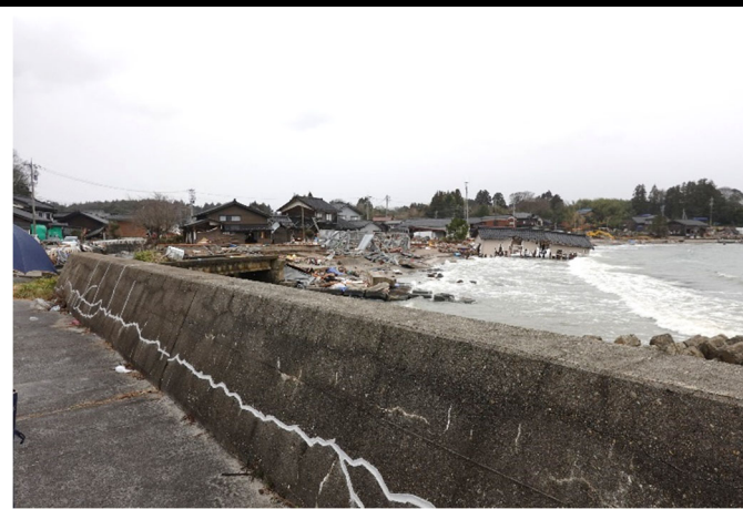
津波被害が発生した白丸地区 6
