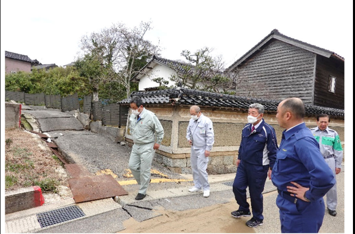
液状化被害を受けた柳瀬地区 4
