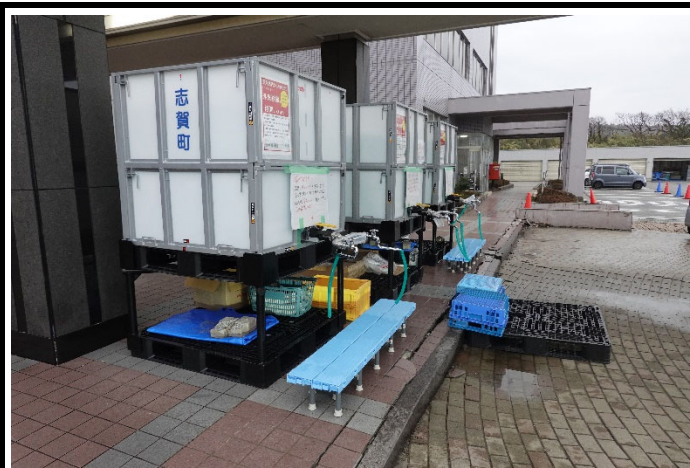
富来行政センターの給水タンク
