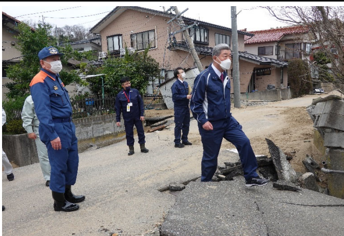
液状化被害を受けた西荒屋地区 4
