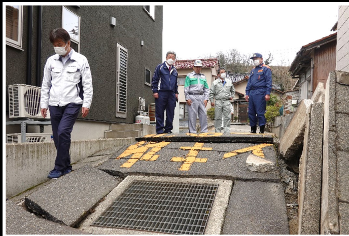
液状化被害を受けた西荒屋地区 5
