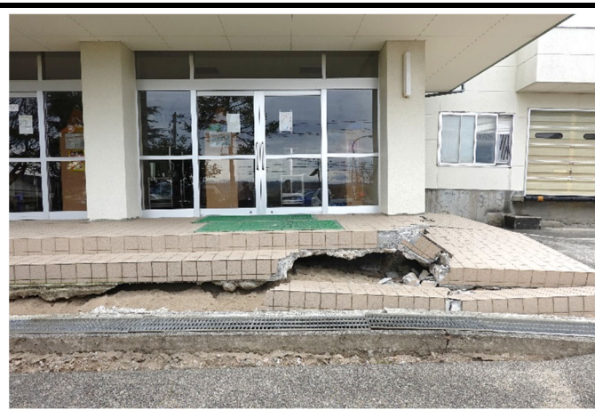
液状化被害を受けた西荒屋小学校玄関 2
