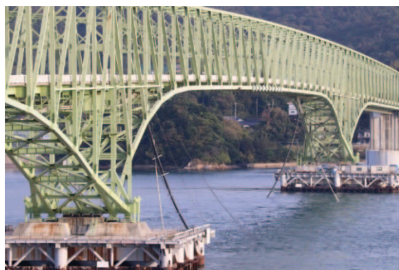
▲大島大橋損傷の全景
