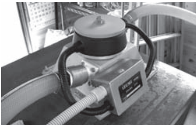
▷設置された小水力発電機
