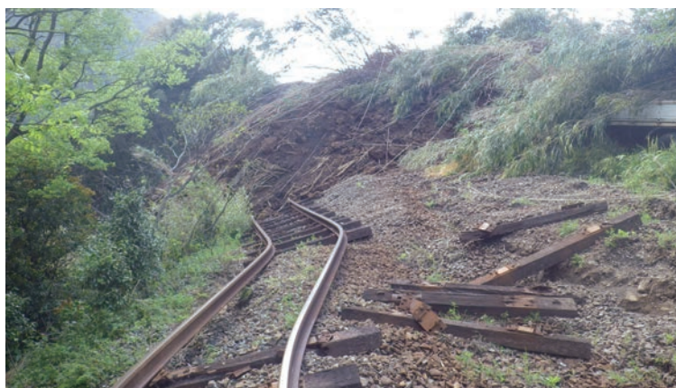
▶南阿蘇鉄道の被害状況の一部
