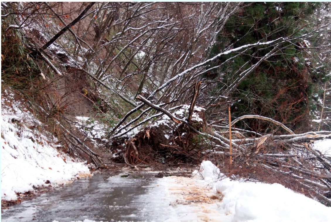
岩手県一戸町 2010.12.23大雨・大雪被害 「季節外れの大雨で崩落した土砂により通行不能となった町道」
