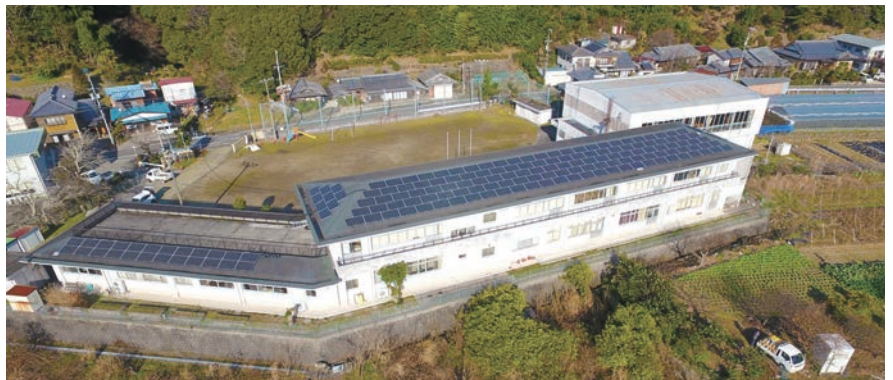
▲廃校となった旧峯口小学校に太陽光発電施設を設置している
