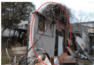
以前は家屋があったが、火災により焼失し、現況は瓦礫として放置（建築物ではない）結果として、雑草の繁茂や不法投棄も併せて発生
