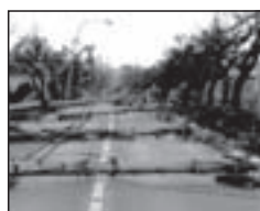
(台風による道路の被災状況)
