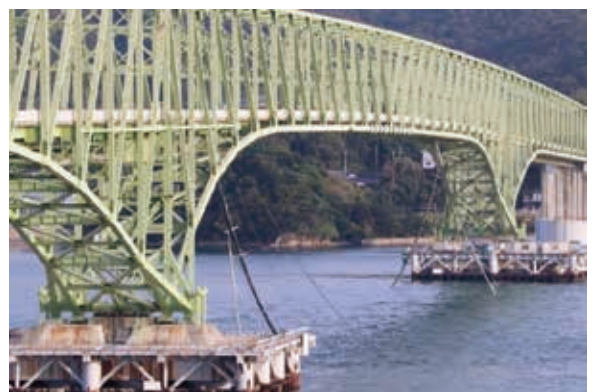
▲大島大橋損傷の全景
